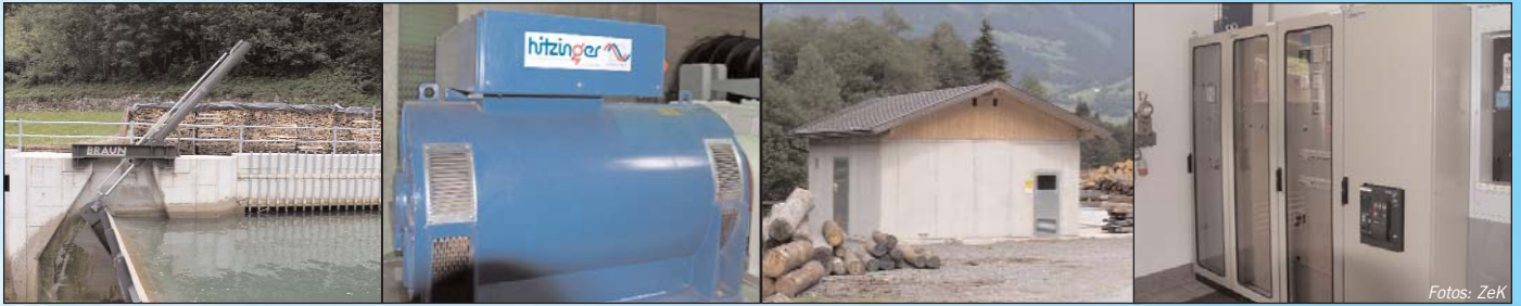
Im Krafthaus (3.v.li) befinden sich der Hitzinger-Generator (2.v.li.) und die TBT-Steuerungsanlage (4.v.li). Braun Wehrklappe mit Hydraulik (1.v.li)
